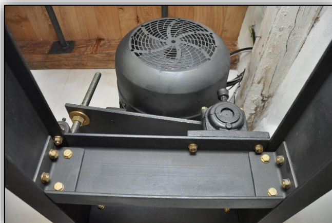
Obr. 10. Detail generátoru i napívací konstrukce celkově upravené tak, aby zařízení nenarušovalo prostor historické elektrárny. (foto D. Veverka, 2017)
