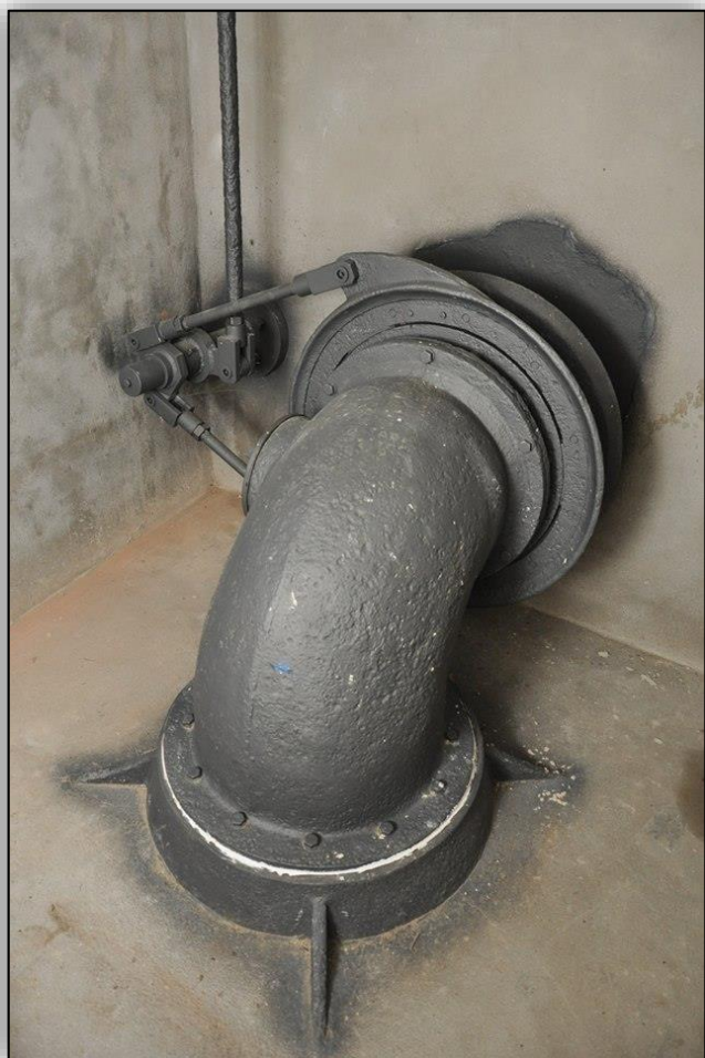
Obr. 7. Francisova turbína po repasování a opravách do funkčního stavu. (foto D. Veverka, 2017)
